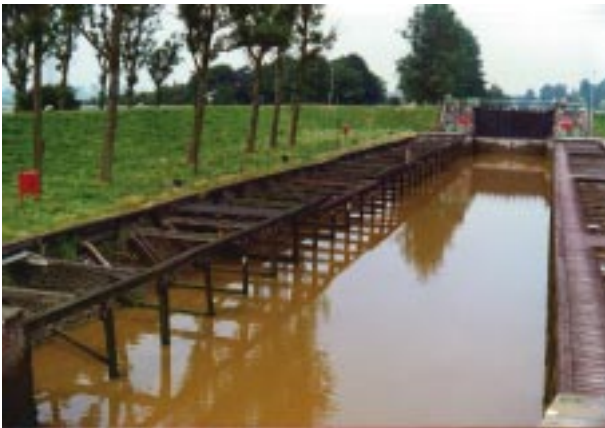
Abb. 3 Schleusenammer vor der Instandsetzung
