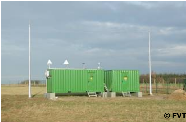
Bild 4: Unterbringung der Systemtechnik (DGPS-Referenzstation Groß-Mohrdorf Ostsee)
