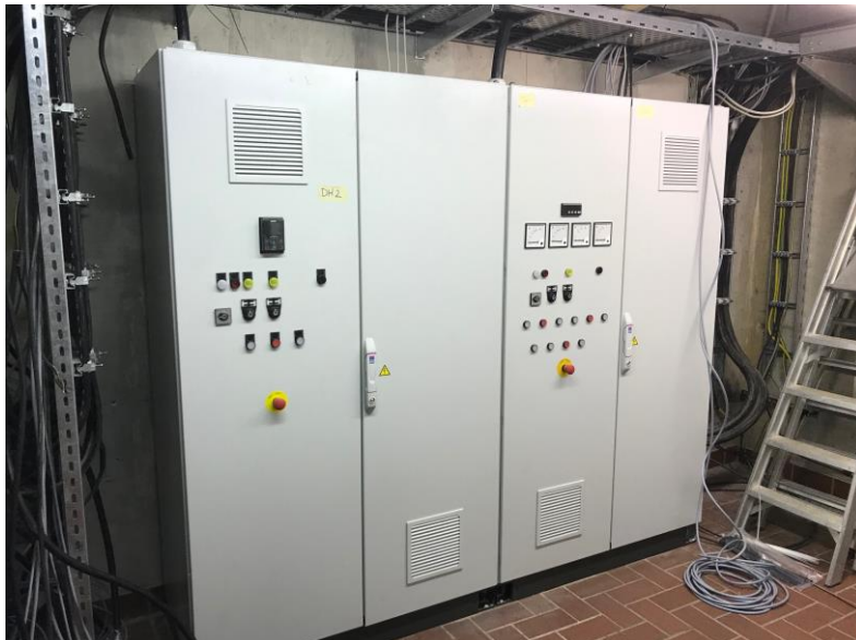
Abb.2: Neue Schaltanlagen im Maschinenraum für das Obertor
