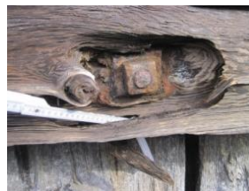
verrotteter Kopfbalken (Holzspundwand)
