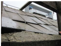
Abgerutschte Böschungsplatten (Schleusenkammer)
