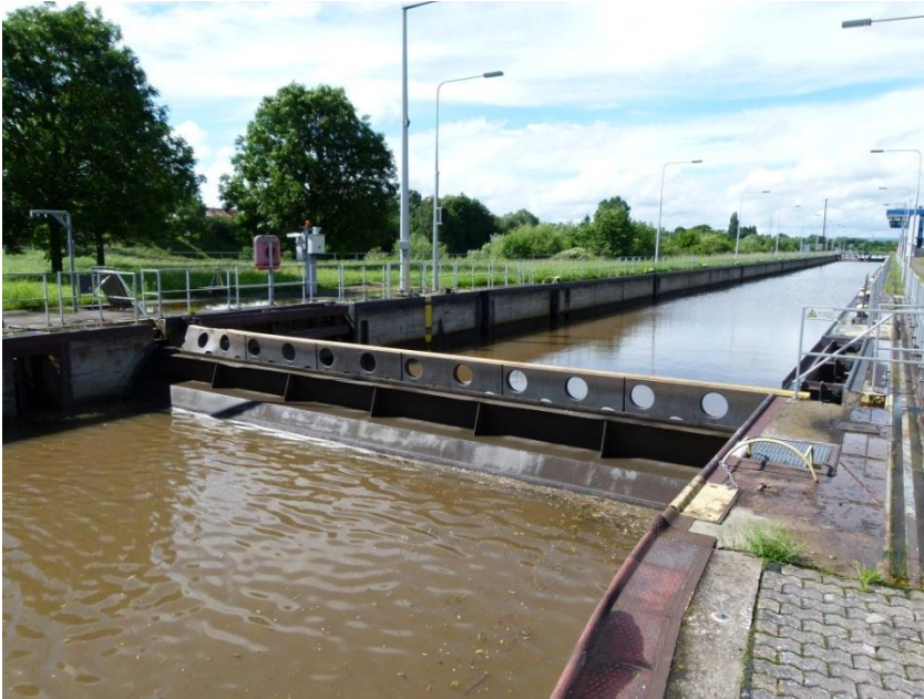
Obertorschaden an der Schleuse Lisdorf
