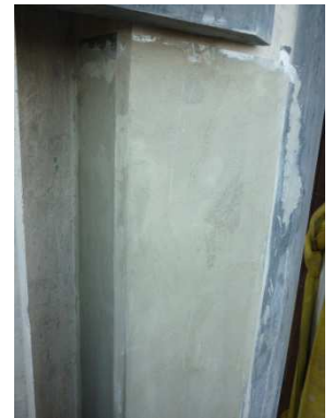
Anfahrsschaden nach Sanierung Mittels Verguss
