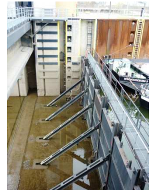
Gesetzter Revisionsverschluss Oberwasser
