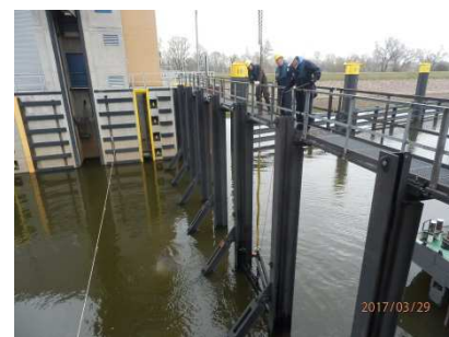
Setzen Revisionsverschluss Unterwasser
