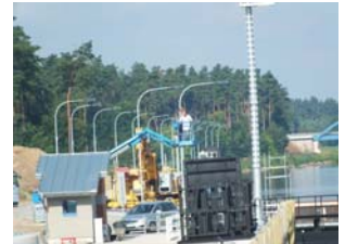
Beleuchtungsanlage und Videomast
