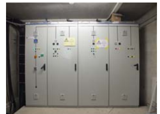
Schaltschränke Unterhaupt Nord
