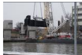
Einhub des rechten Wehrverschlusses
