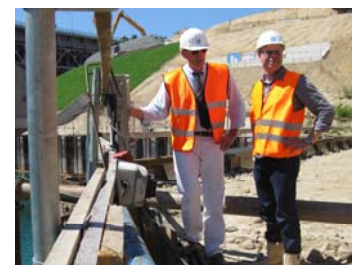
17.06.2010 – am Schalter der Pumpenanlage v.l.n.r.: Bürgermeister Hartmut Teichmann, Bauleiter Jan Held (Bilfinger Berger Ingenieurbau GmbH)
