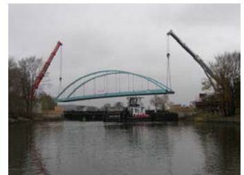
10.11.2009 – Einheben des in Lunow vormontierten und per Schiff zum Einbauort transportierten neuen Brückenüberbaus
