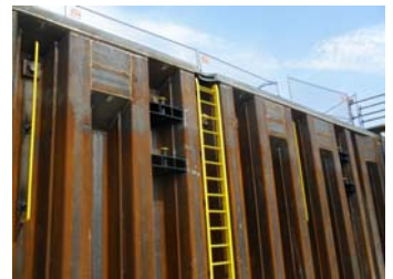
26.04.2010 – großzügige Ausrüstung der Schleusen-kammer mit Pollern, Haltestangen und Steigeleitern
