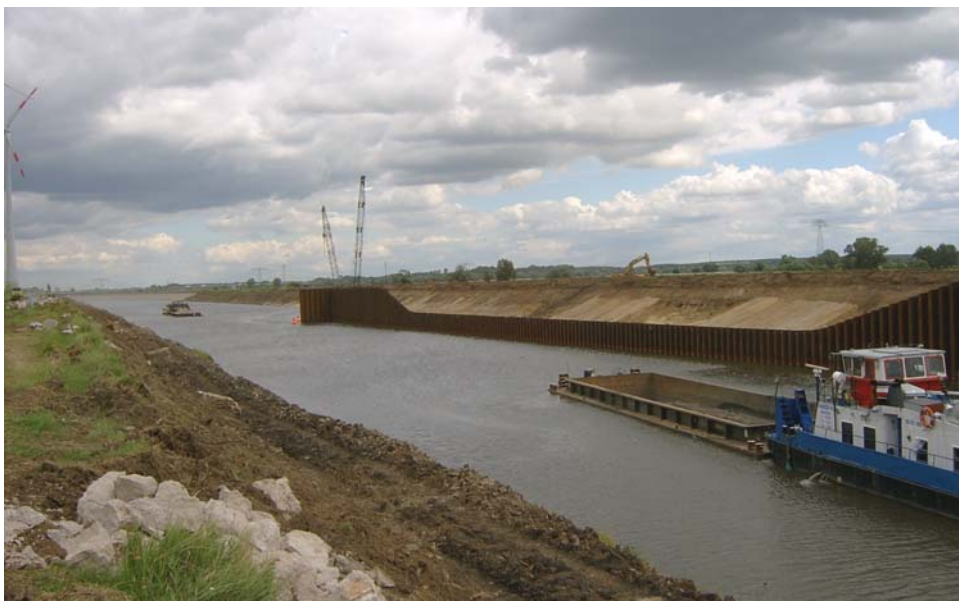
Bild 1: Die östliche Spundwand des Fangedamms ist errichtet und lässt die Kontur der späteren Schleuse bereits erahnen. In der Bauphase I der Schifffahrt wird auf der Ostseite dieser Spundwand gearbeitet während auf der Westseite der Schiffsverkehr die Baustelle passieren kann.
