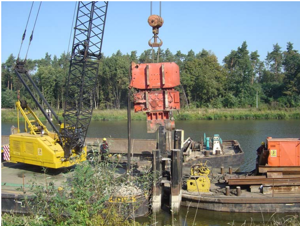
Bild 3: Vom Ponton aus werden am 13.09.06 am Südufer des Unteren Vorhafens die alten Anlegedalben mit einem Vibrationsbär gezogen
