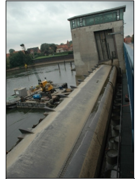
Blick in die trockengelegte Wehranlage. Betonbrunnenringe dienen auf der Wehrsohle als Ballast.
