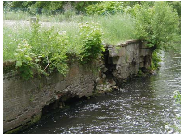
Der Massivbauteil des Wehres Liepe ist nicht mehr standsicher und muss ersetzt werden.
