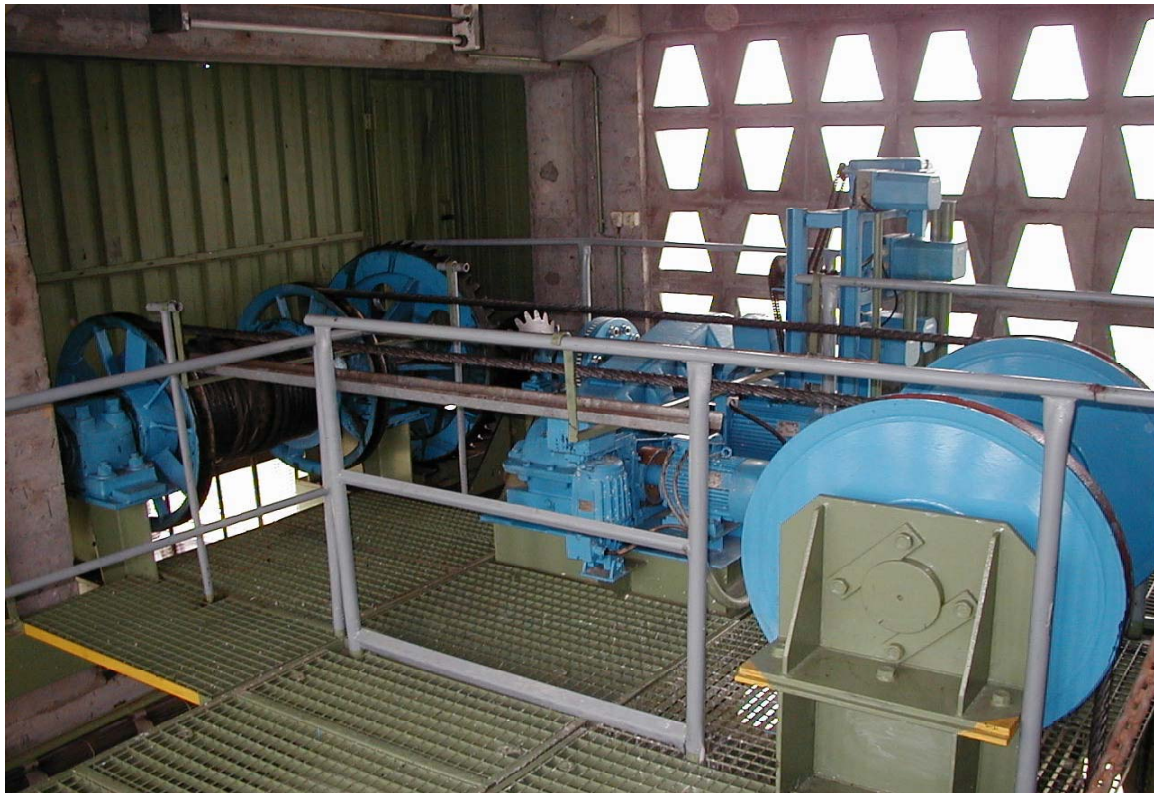
vorhandener Antrieb für ein Schleusentor
