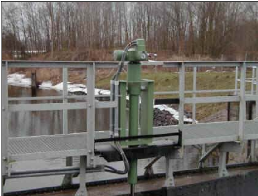
Elektrohubzylinder zum Antrieb eines Klappschützes am Binnenhaupt
