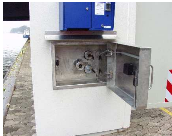
„Trinkwasserzapfsäule“ am Mittellandkanal in Höhe der Marienbrücke
