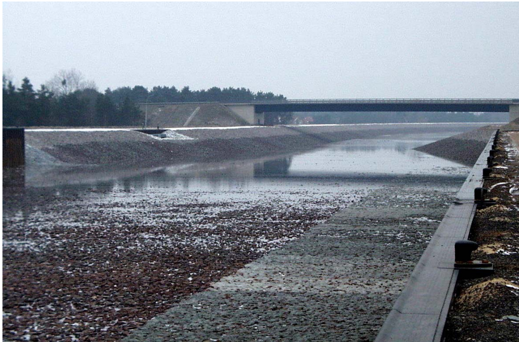
Abb. 4 Flutung im Februar 2003
