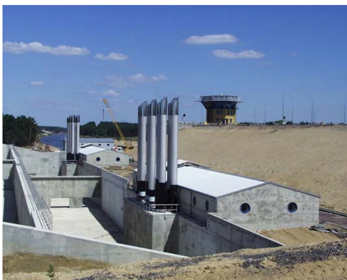
Abb. 3 Be- und Entlüftungstürme
