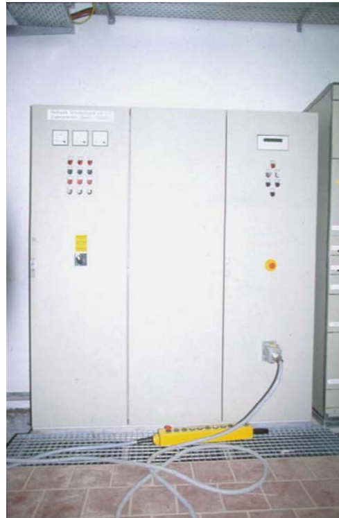
Abb. 4 Schleusenanlage Rothensee, Antrieb Zugsegmenttor, Hydrauliksteuerung
