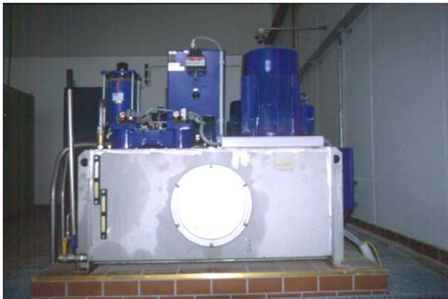
Abb. 9 Schleusenanlage Rothensee, Hydraulikaggregat der SBV
