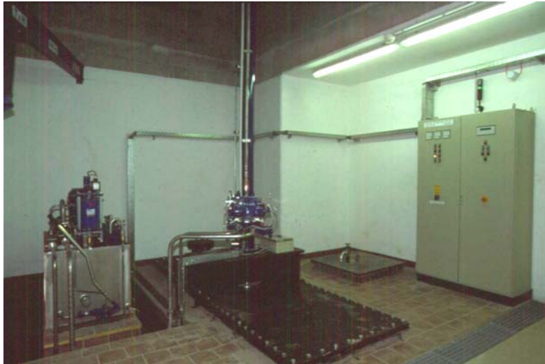
Abb. 6 Schleusenanlage Rothensee, LKV-Antrieb
