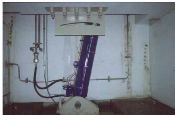
Abb. 3 Schleusenanlage Rothensee, Antriebszylinder Zugsegmenttor
