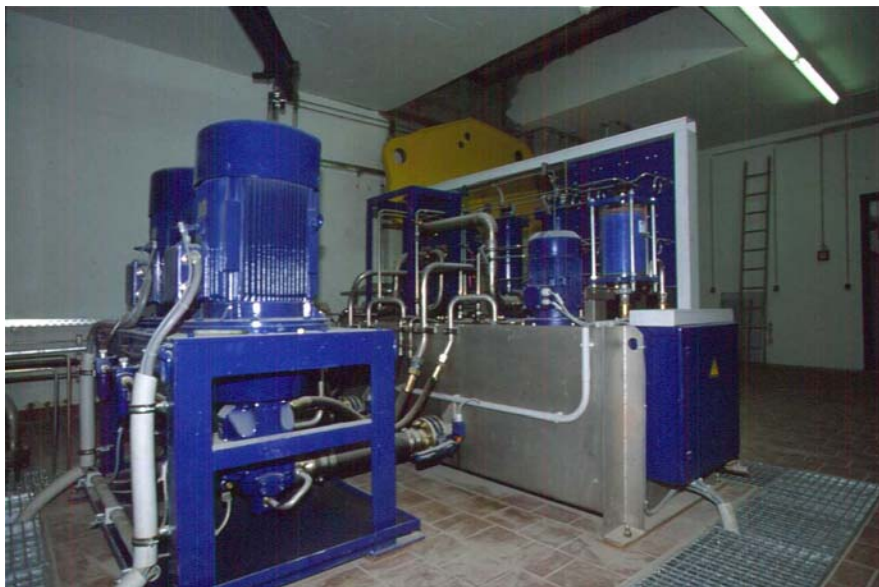
Abb. 2 Schleusenanlage Rothensee, Antrieb Zugsegmenttor, Hydraulikaggregat
