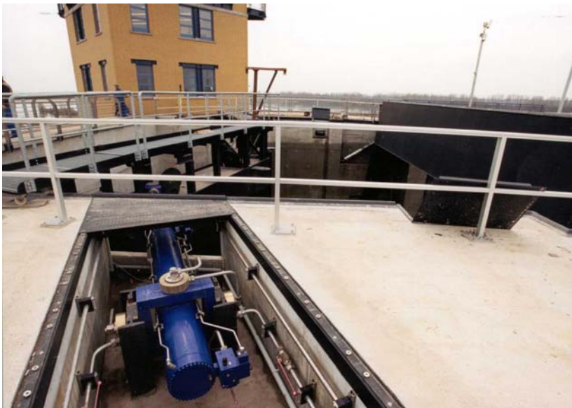
Abb. 5 Schleusenanlage Rothensee, Antriebszylinder Stemmtor
