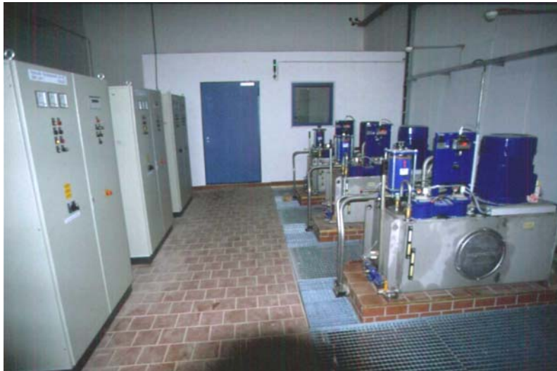
Abb. 7 Schleusenanlage Rothensee, SBV-Antriebe in der Maschinenhalle
