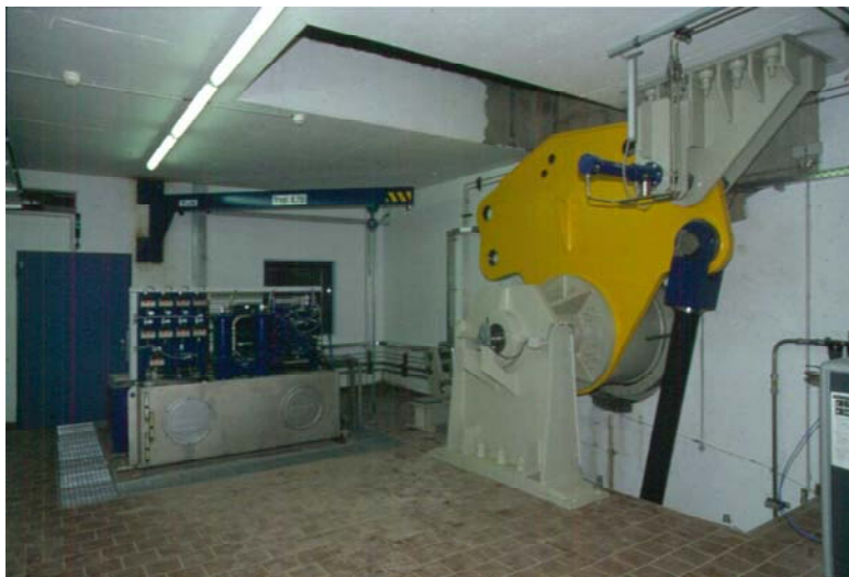
Abb.1 Schleusenanlage Rothensee, Antrieb Zugsegmenttor
